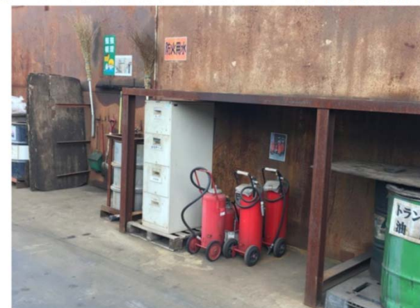
図 17 消火器の設置事例
